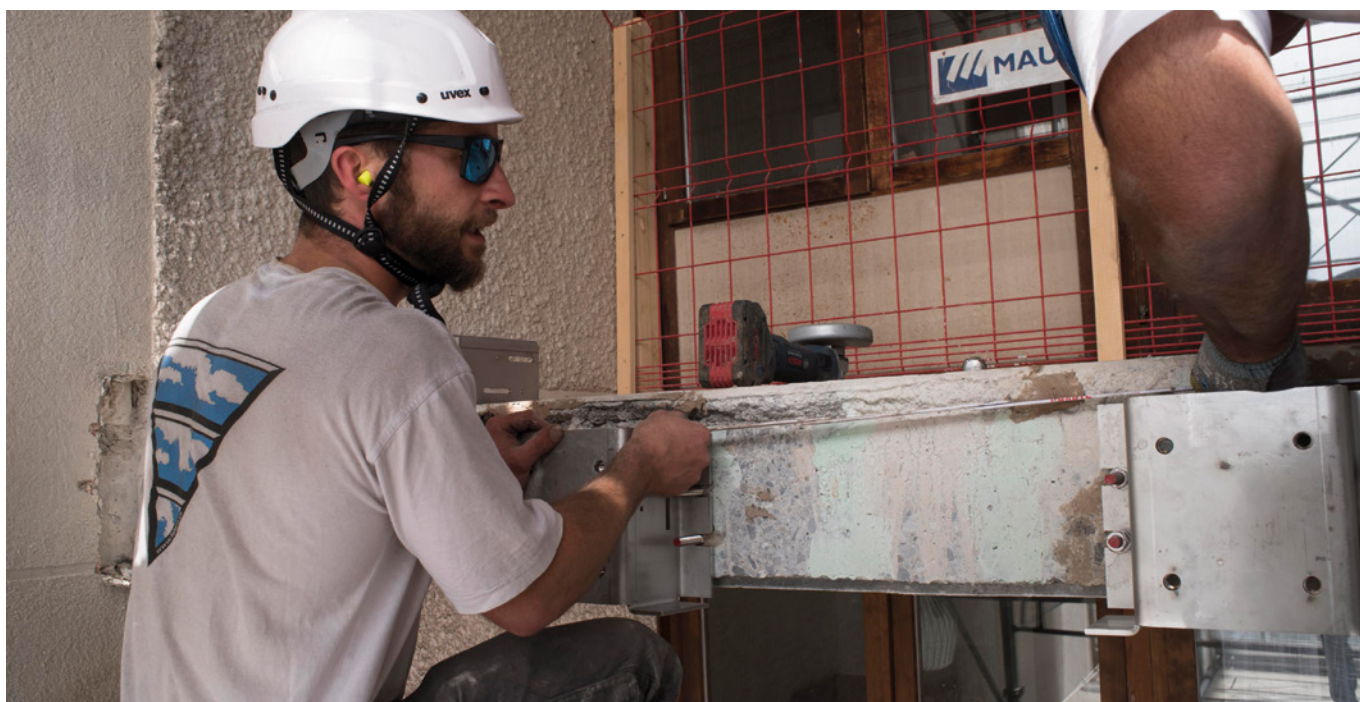
LES SERRURIERS SONT À PIED D'OEUVRE POUR POSER LES SUPPORTS DES NOUVELLES BARRIÈRES DES LOGGIAS.
